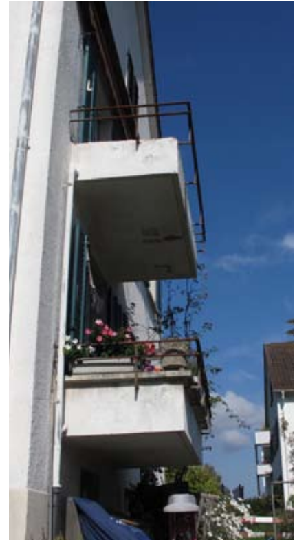
Die Baufälligkeit ist nur ein Thema: Daneben entsprechen die Balkone am Rain den heutigen Sicherheitsnormen in keiner Art und Weise!
